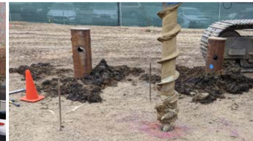
SEHC – Test Torque Pile
