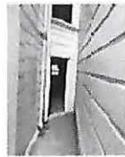
FIG. 2: SINK OVER DOOR
